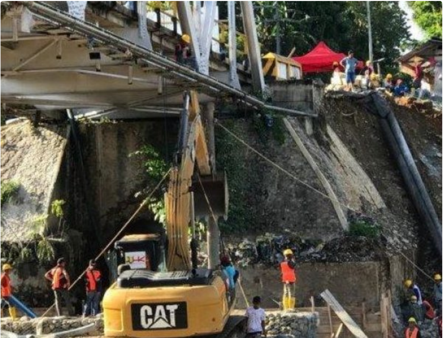
Jembatan Rampoang di Kota Palopo yang mengalami kerusakan pada tahun 2019. (Foto: IniPalopo.com)
